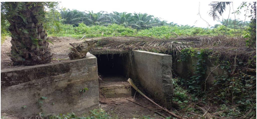
(Dokumentasi Solidaritas Perempuan: Pintu air untuk menguras air rawa-rawa yang direncanakan menjadi lokasi transmigrasi)
