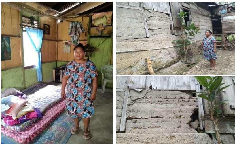
Kondisi rumah ibu yernalis bagian ruang tamu yang dijadikan tempat tidur dan dinding kamar tidur yang retak dan hampir roboh
