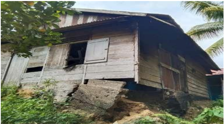
Kondisi tempat tinggal keluarga bapak yadi tenggeli yang terdampak, pondasi rumah hancur terpisah dari bangunan rumah
