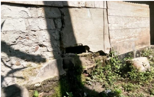
gambar kerusakan dinding rumah ibu jati semani djepa
