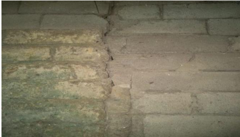
gambar kerusakan dinding kamar tidur bapak jasman siore
