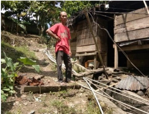
Kondisi tempat tinggal bapak Resmi suno, pondasi rumah turun, kondisi rumah miring ke arah sungai
