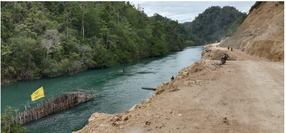
Pelebaran sungai mengakibatkan pagar sogili masyarakat tenggelam dan rusak pelebaran di lakukan bersama dengan pembuatan jalan baru di pinggir sungai dari PLTA Poso 1 menuju Kota Tentena.
