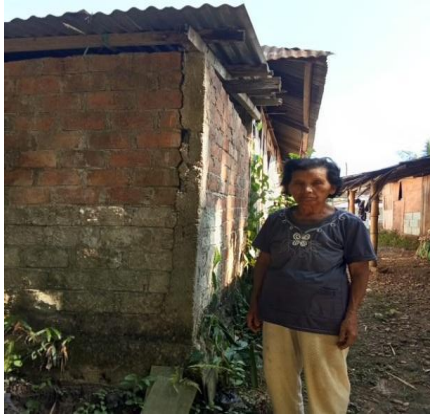
gambar kerusakan dinding dapur tempat tinggal ibu Djaimu Biulu
