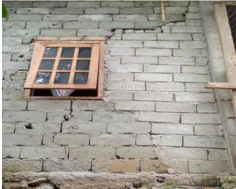
gambar dinding rumah yang retak rumah Miden Badjaji
