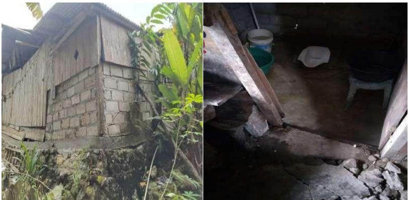
Rumah ibu Malvin dari luar terlihat pondasi rumah turun tidak persisi lagi dan gambar kiri bagian dalam kamar mandi yang terlihat retakan serta lantai kamar mandi yang rusak parah
