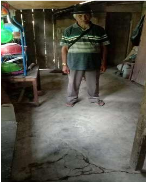
Kondisi Rumah bapak Dirmas Tenggeli terdampak mengakibatkan retakan pada lantai dan dinding rumah
